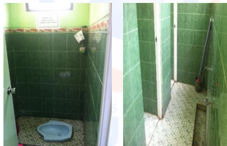
Gambar 5. Kondisi kamar mandi sekolah setelah
