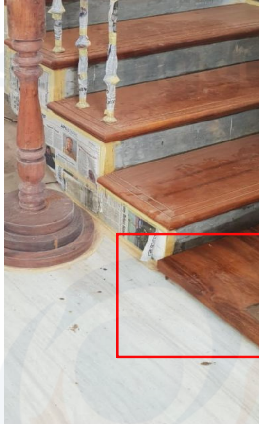
Gambar 14. Bagian Yang Diberi Kotak Adalah Step Tambahan Sehingga Terdapat Perbedaan Ketinggian Pada Tangga Tersebut Dengan Ruang Lainnya (Sumber: Erina Wiyono, 2018)
