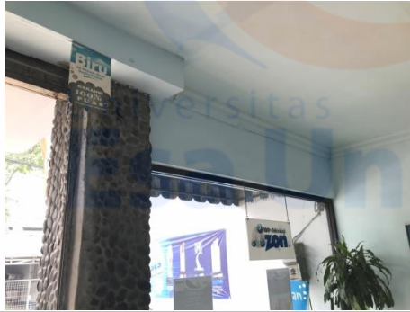
Kondisi langit-langit dan dinding
