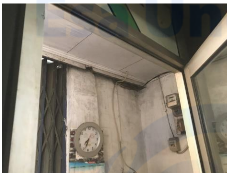
Kondisi langit-langit dan dinding
