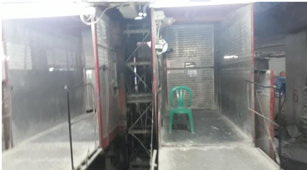
Pesawat angkat-angkut untuk memindahkan sampah di tiap lantai
