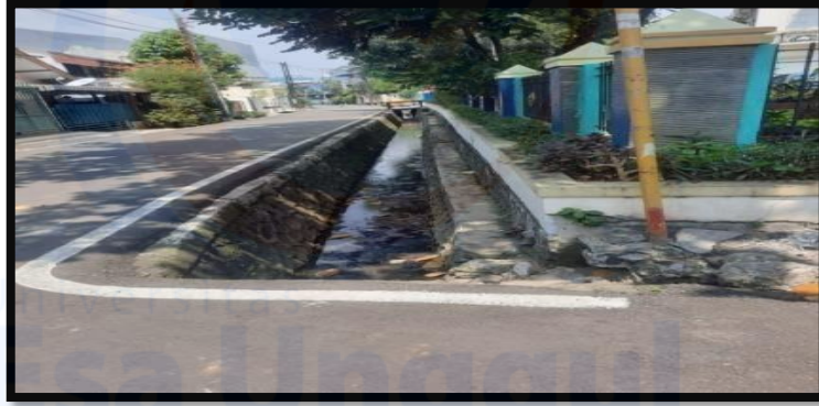
Gambar 1.17 Kondisi Drainase Pada Peemukiman Elit
