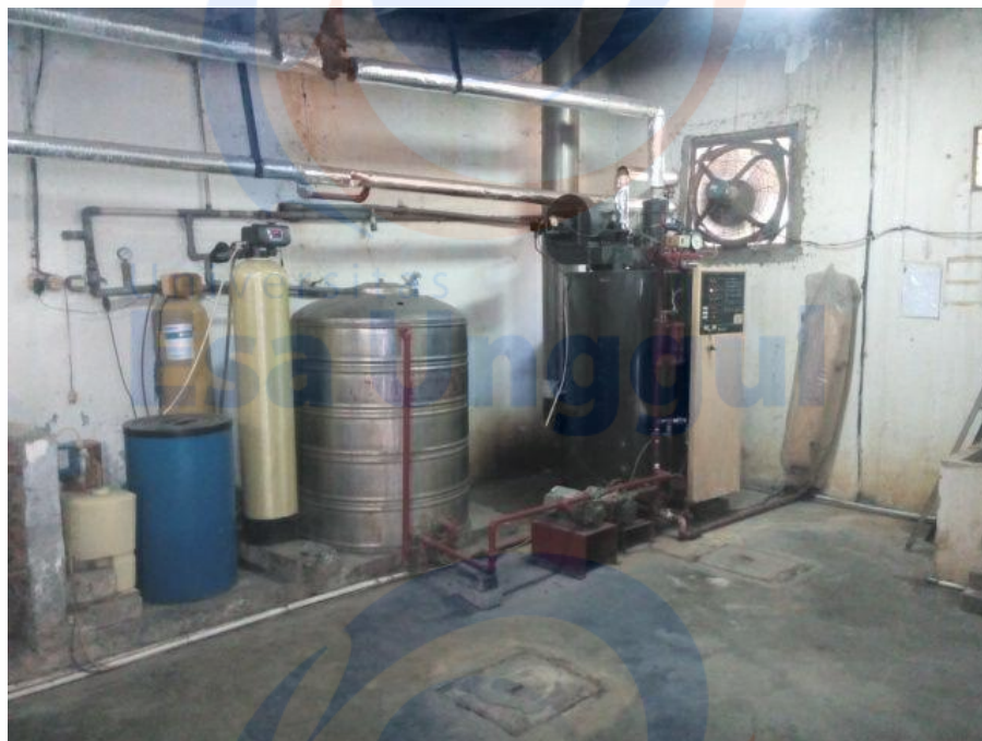
Peralatan Boiler PT SandangMutiaraCemerlang. Jarak dengan ruang produksi 7 meter
