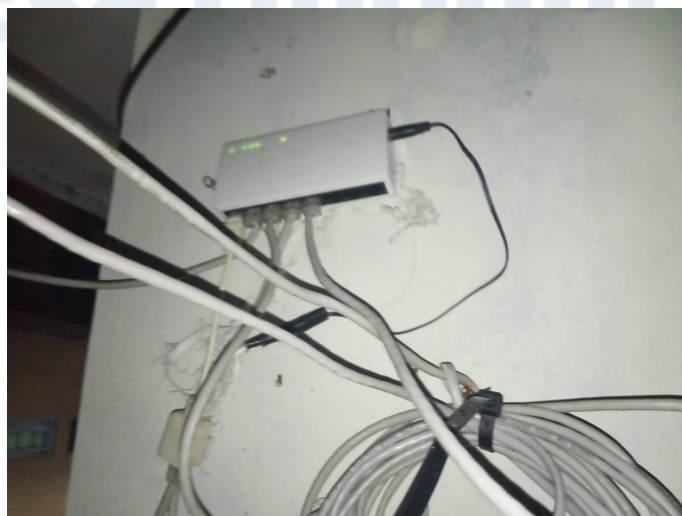
Gambar Lampiran 3 Switch Stasiun
