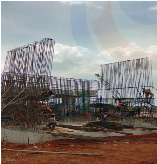
Proses pemasangan besi abutment kondisi besi berkarat
