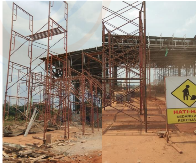
Proses pembuatan gerbang tol, Kondisi Scaffolding yang berkarat dan berdebu
