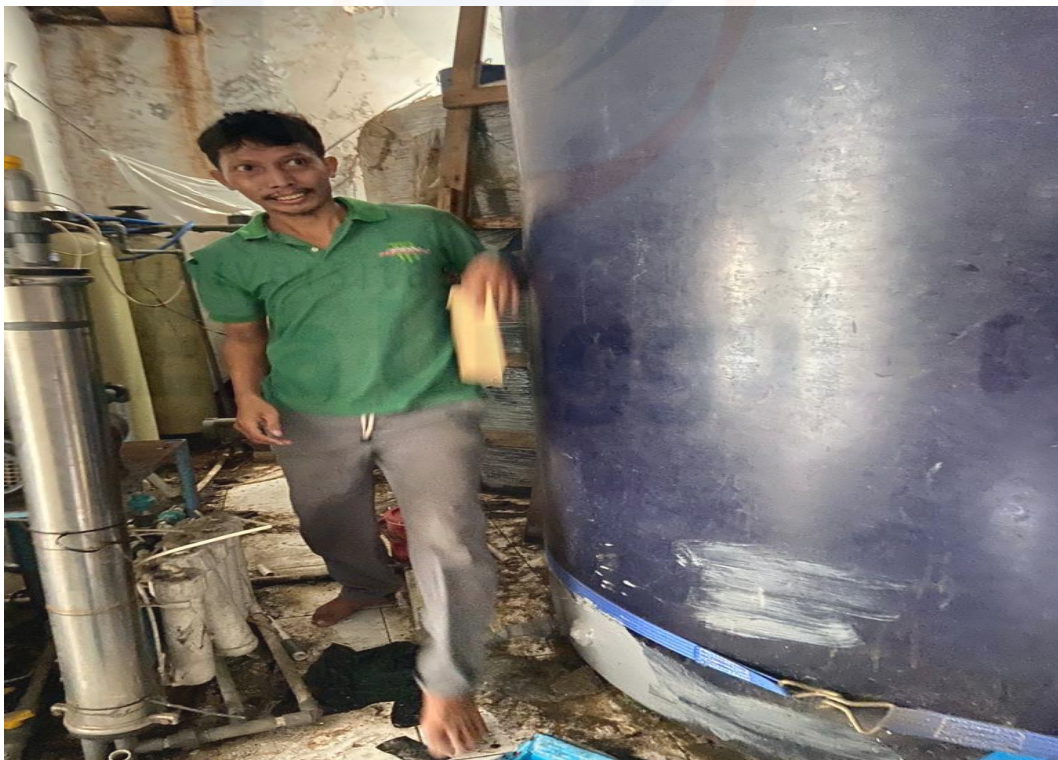
Penjamah/pekerja tidak memakai pakaian kerja dan alas kaki
