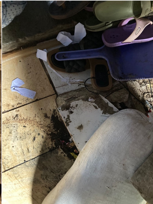
main hole septic tank di wilayah Kelurahan Jati pulo
