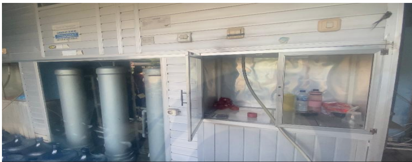
(Keterangan : Jalan akses keluar air tidak menggunakan alat Nozzle )
