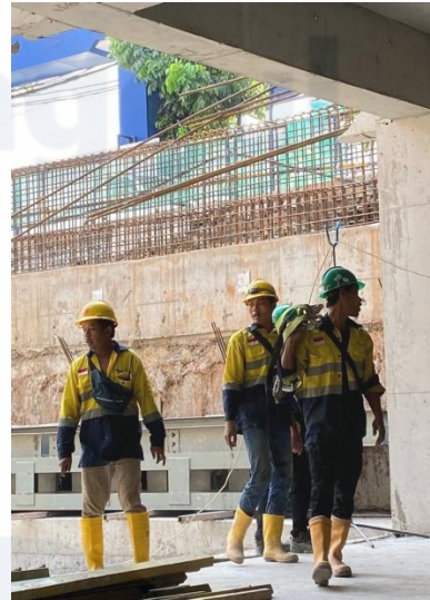
(Pekerja yang bekerja tidak menggunakan masker)
